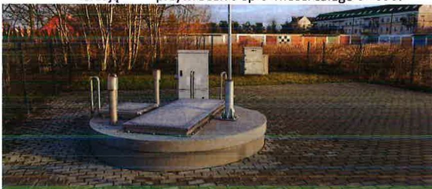
Przepompownia ścieków PS 3 NOWA
